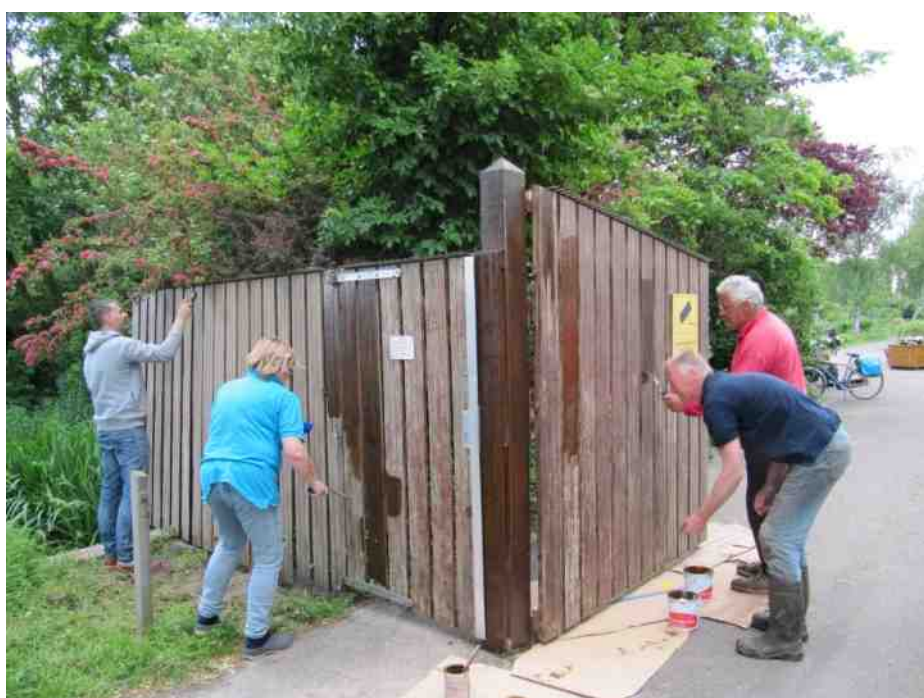
Het grote toegangshek aan het Henstraplein was nodig aan opknappbeurt toe. Na intensief schuren, zorgde deze AW-ploeg voor een verse laag beits. DS
