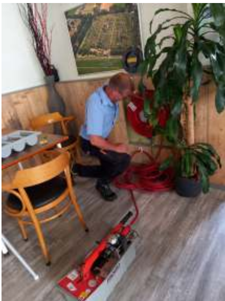
De brandhospels en brandblussers werden dit jaar ook weer door de brandweer gecontroleerd en in orde bevonden.
