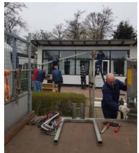
Op de foto rechts, gemaakt in het vroege voorjaar, wordt de "oude" overkapping van het terras verwijderd. Duidelijk is zichtbaar dat de aansluiting op de kantine dwars over de bovenramen liep. Deze is nu verhoogd tot onder het dak. Onze tuinder John van Galen van het gelijknamige constructiebedrijf, ondersteunde de klus met raad en daad. Foto Carla
