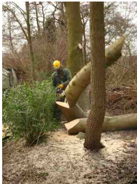
De firma Heeremans op de dijk in actie na een zware storm. Foto Sjoek
